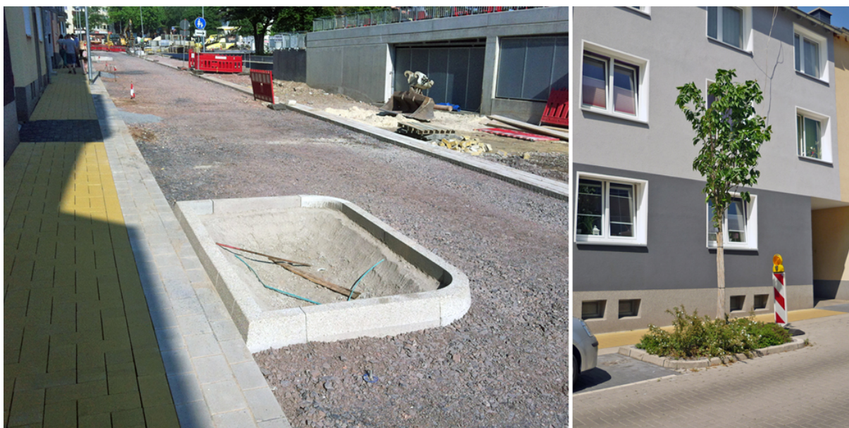
Abb. 4. Ergebnis der Anlage eines ungeeigneten Baumstandortes. Die mindestens notwendigen 12 m 3 Wurzelraum wurden an dieser Stelle nicht einmal ansatzweise erzielt. Die Pflanzung eines Baumes ist an einem solchen Standort eine dauerhaft lediglich Kosten mit sich bringende, vollständig sinnlose Investition - da er sich noch nicht einmal notgedrungen aus eigenem Antrieb über die ihm aufgezeigten Grenzen hinaus entwickeln kann.
